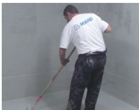
Mapelastic Foundation , påført med rulle, for at tætne mod vand med negativt tryk
